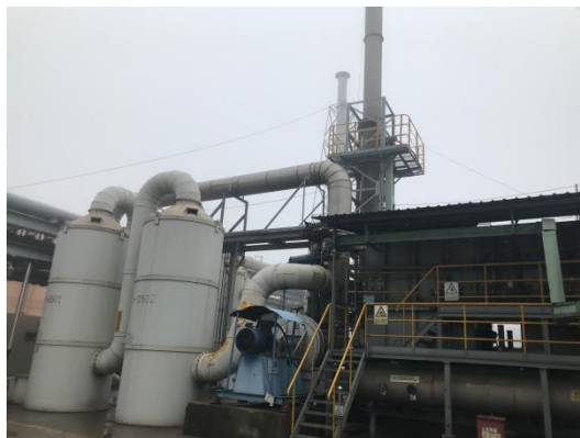
▲RTO 废气焚烧装置
